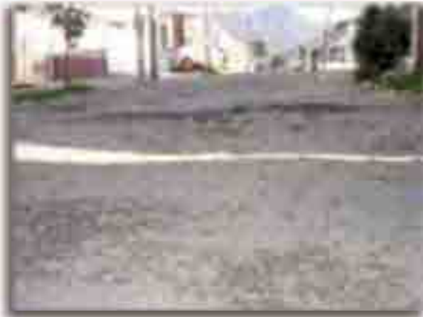
Foto 27. Estado de las vías y los andenes.
